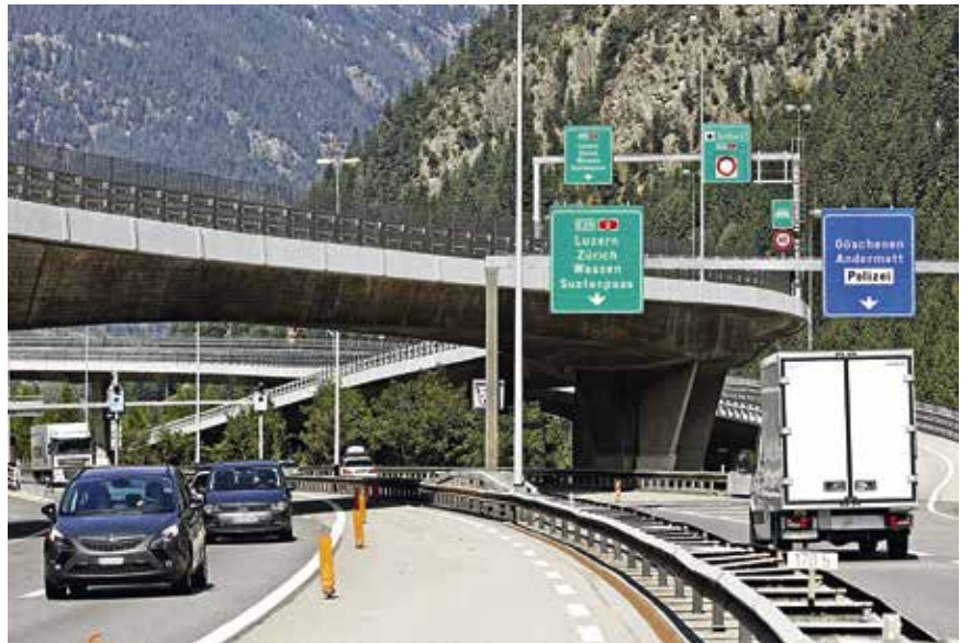
Einfahrt in den sanierungsbedürftigen Gotthardtunnel.
